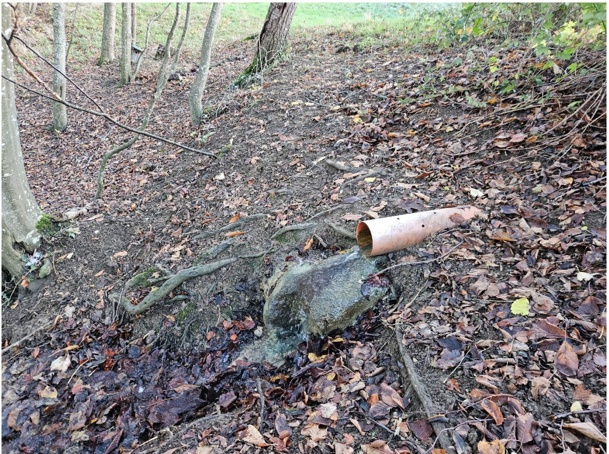
Bild: Auslauf Drainage mit Kalkablagerungen (Quelle: Gemeinde Buus)
